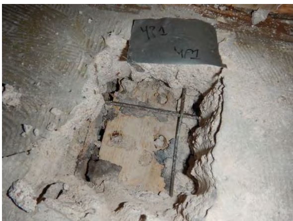
Kuva 16. Rakenneavaus YP1. Yläpohjarakenne on kaksoislaattapalkisto. Pintalaatan alla on muottilaudoitus, joka päällä on tervapaperi.
