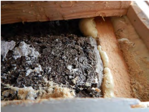
Kuva 7. Rakenneavaus US2. Erkkeri-ikkunan yläpuolella on käytetty korkieristettä. Eristeestä otettiin materiaalinäyte mikrobien suoraviljelyyn (näyte 2).
