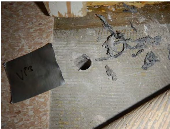
Kuva 14. Rakenneavaus VP3. Toisen kerroksen kylpyhuoneen betonirakenteisessa välipohjassa on käytetty bitumista vedeneristysvivelyä.
