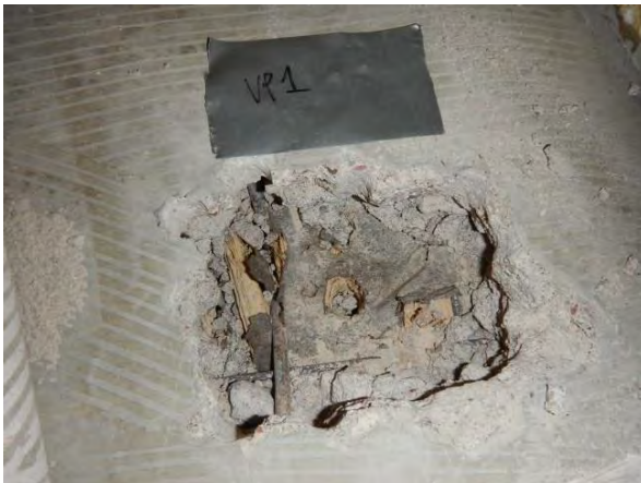
Kuva 10. Rakenneavaus VP1. Välipohjarakenne on kaksoislaattapalkisto. Pintalaatan alla on muottilaudoitus, joka päällä on tervapaperi.
