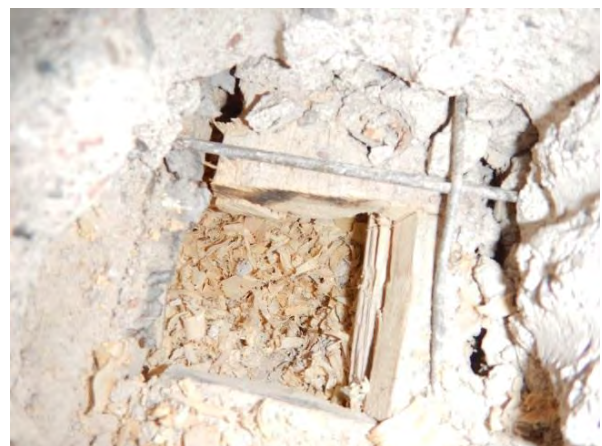
Kuva 17. Rakenneavaus YP1. Yläpohjan eristeenä on käytetty kutterilastua. Eristeestä otettiin materiaalinäyte mikrobien suoraviljelyyn (näyte 8).
