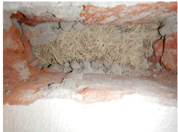
Kuva 4. Rakenneavaus US1. Maanvastaisen seinän eristeenä on käytetty lastusementtilevyä. Eristeestä otettiin näyte mikrobien suoraviljelyyn (näyte 1).
