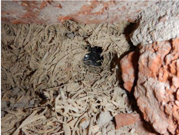
Kuva 5. Rakenneavaus US1. Maanvastaisen ulkoseinän ulkokuoren sisäpinnassa on bitumisively.
